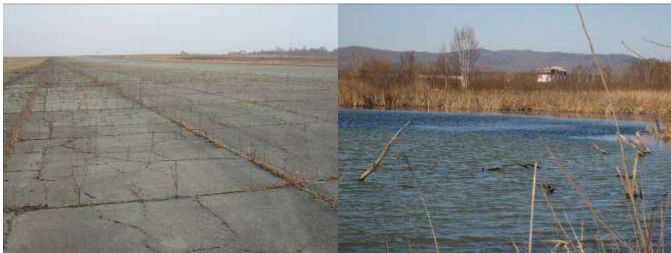
Рисунок 5. ВПП до реконструкции и озеро за пределами существующей полосы в зоне её удлинения
